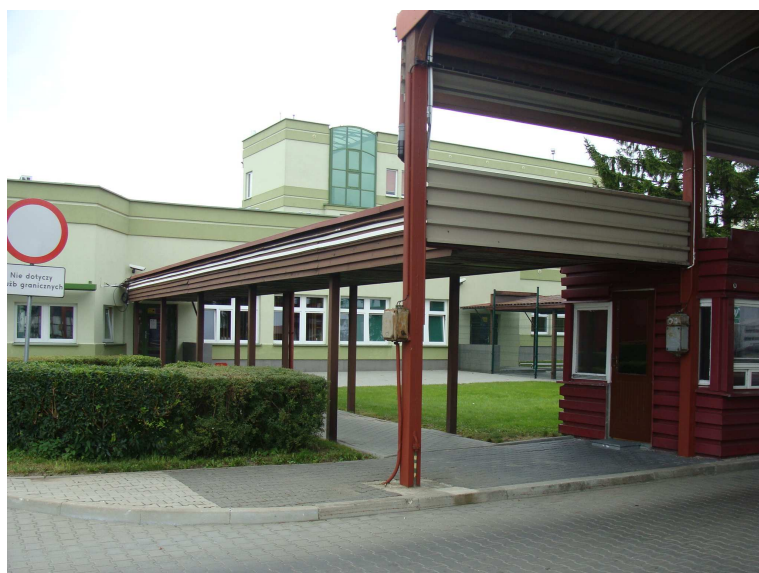
Fot. nr 1, 2. Istniejące zadaszenia nad ciągami pieszymi przeznaczone do rozbiórki.
